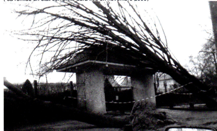
Le porche d'entrée de l'Ecole après la tempête
